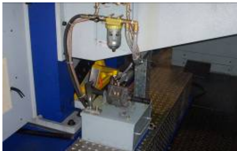
Rücklaufbehälter, automatische Ölrückführung In Fass
