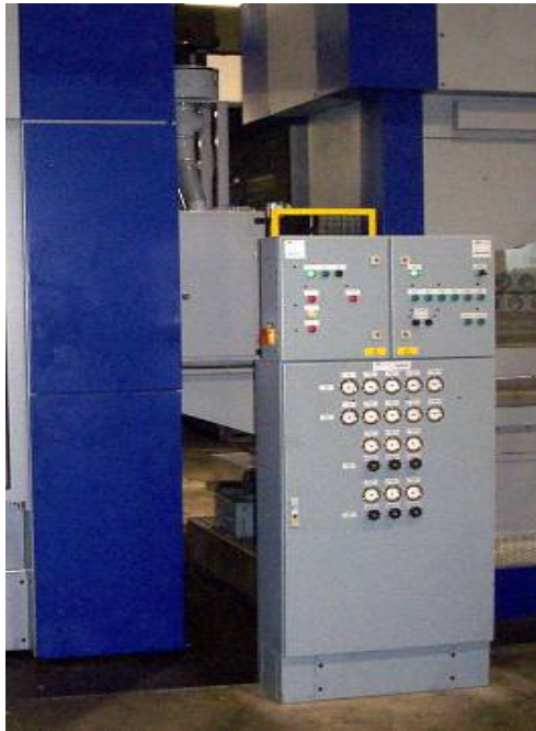
Ventilschrank mit aufgesetzten Elektroschränken
